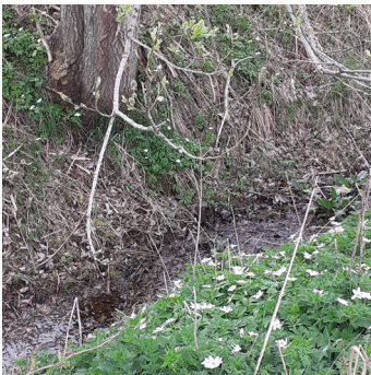
Diket är vattenförande maj månad.
